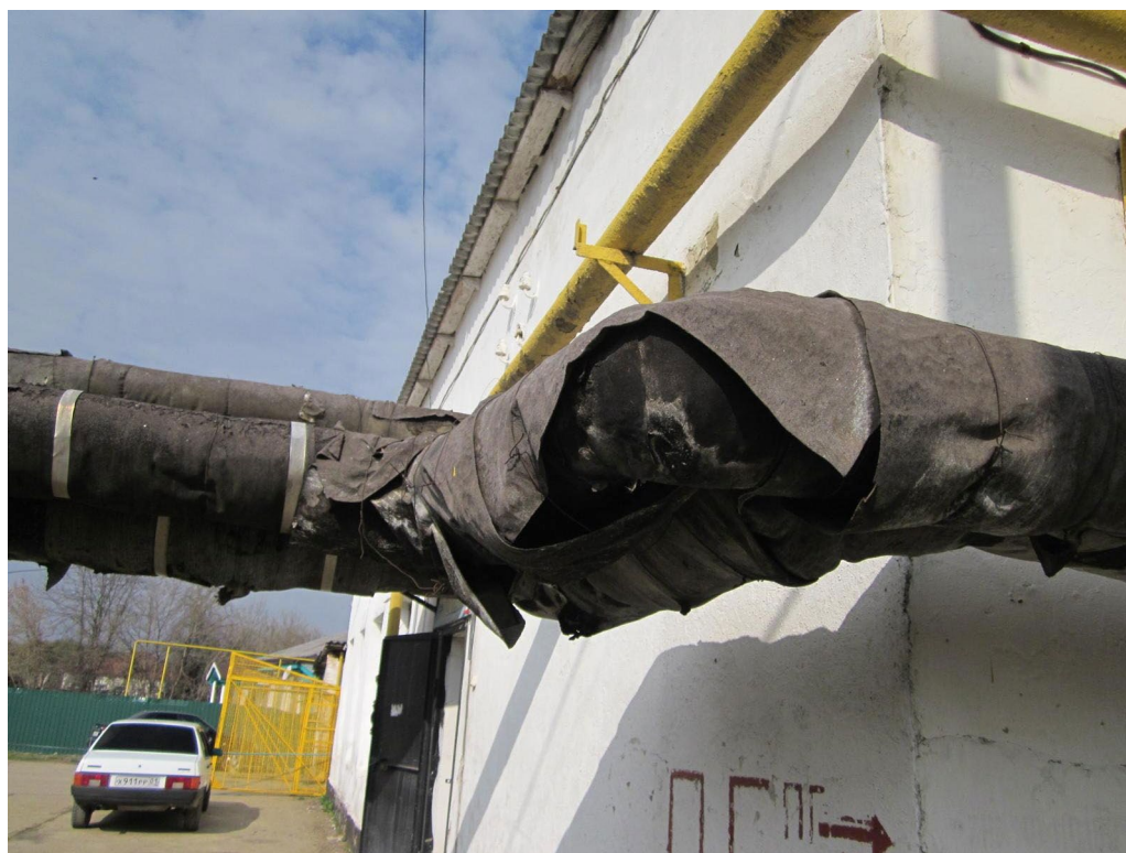
Рисунок Теплотрасса котельной №2
