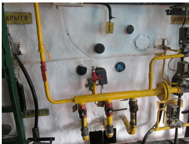
Рисунок Котёл универсал в котельной №2
