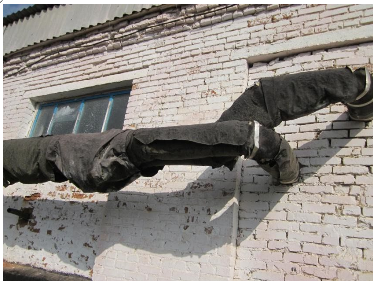
Рисунок. Теплотрасса Котельной №1
