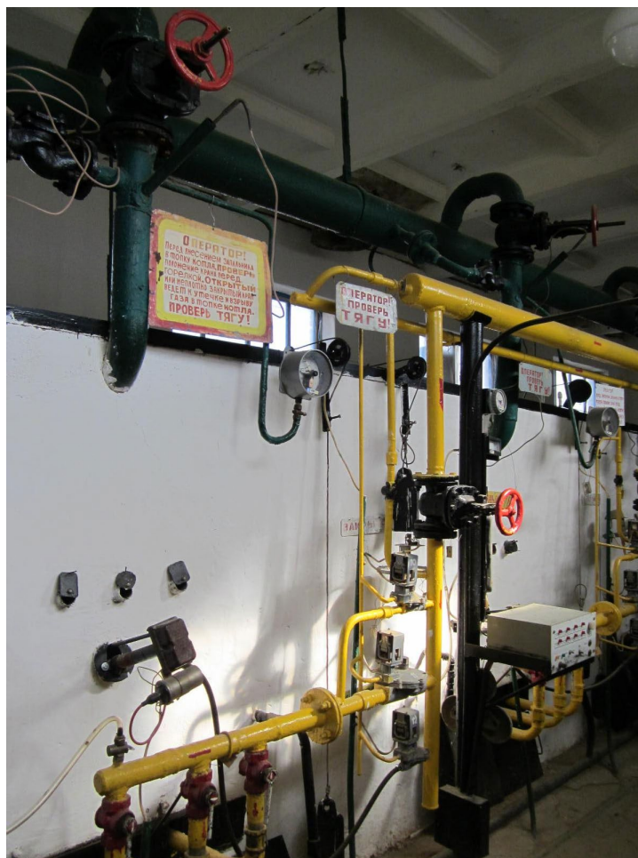
Рисунок. Оборудование котельной №1
