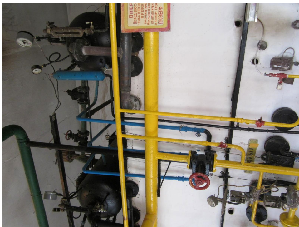
Рисунок Оборудование котельной №2.
